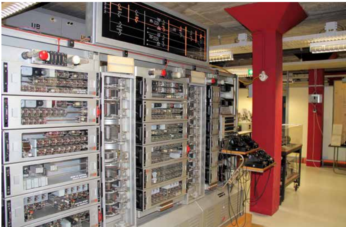
De werkende centrale type 7 E.
